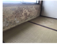
北側の壁に発生したカビ
