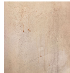
壁の結露（北面）
