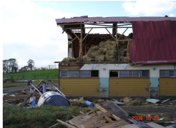
図 19 B 地点の畜舎の被害(A damaged livestock barn)
