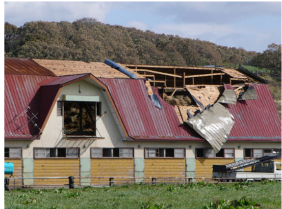
図 17 B 地点の畜舎の被害(A damaged livestock barn)
