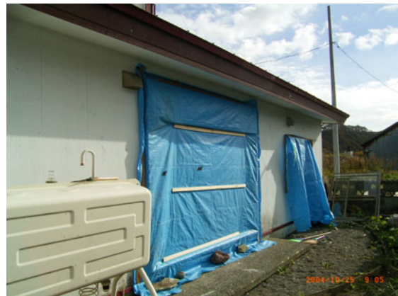
図 13 外壁への飛来物の衝突(A damaged wall by a windborne missile)
