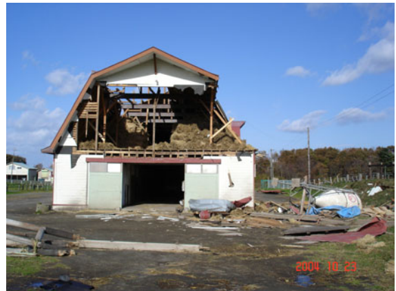
図 18 B 地点の畜舎の被害(A damaged livestock barn)
