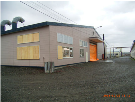
図 15 A'地点の工場の被害(Damaged windowpanes of a factory building)
