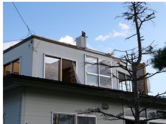
図6 屋根小屋組みの飛散した住宅(Damaged Roof frameworks of a wooden house)
