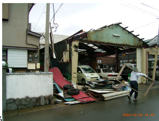
53 伊東市宇佐美 住宅 屋根，壁の損傷
