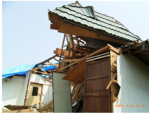
写真4 本願寺周辺，家屋の全壊
