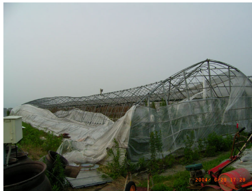
写真6 ビニルハウスの被害
