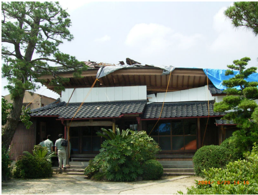
写真3 本願寺の損傷（屋根小屋組のずれ）
