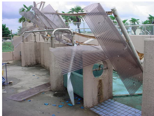
写真8 西与賀小学校プールついでへの損傷
