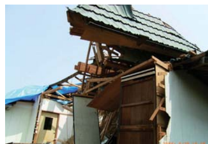
写真3 本願寺周辺、家屋の全壊
