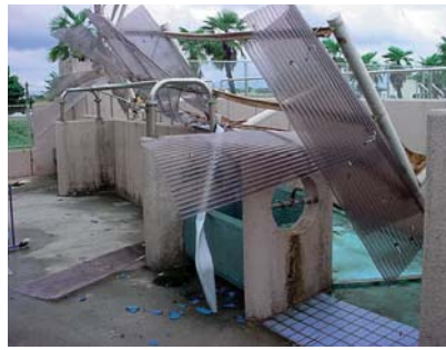
写真6 西与賀小学校プール 日除け屋根の損傷
