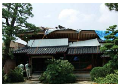
写真2 本願寺の損傷 (屋根小屋組のずれ)
