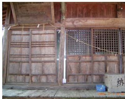
写真3 御霊神社倒木による 骨組の傾斜
