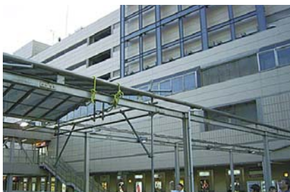
写真3 スパン約3.8m、長さ約10mの歩道連絡橋の屋根が強風により飛散した
