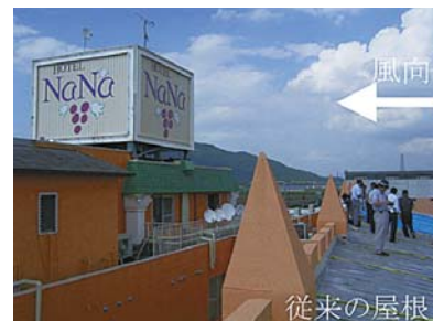
写真2 屋根は高く舞い上がり、前方の構造物(広告塔)を飛び越えた
