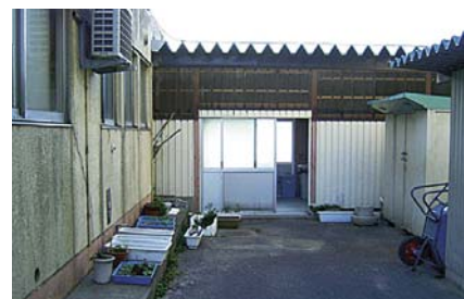
写真4 大きさ950mm×950mm厚さ3mmの窓ガラスが突風により破損した
