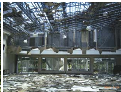
大ホール内部の天井、内装被害
