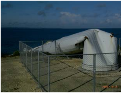
マスト本体の座屈による倒壊
