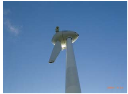
ブレードの被害
