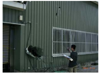
壁面に飛来物衝突跡
