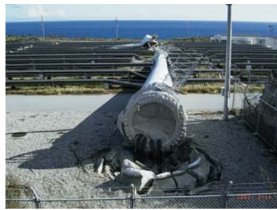
基礎生じた損傷による倒壊
