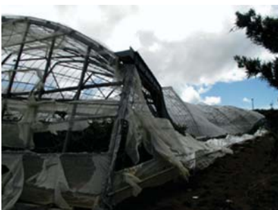
写真4 農業ハウスの被害
