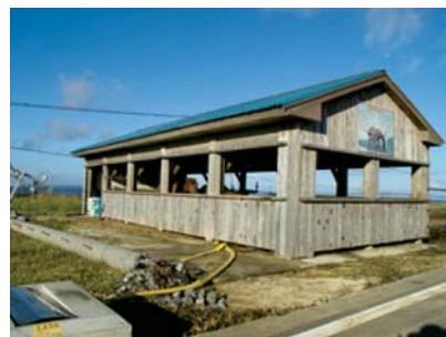
写真5 無被害の畜舎に隣接する電柱は折損している。
