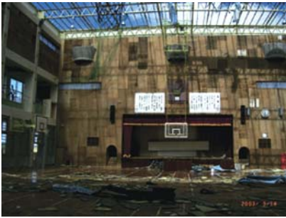
天井、内装材の剥がれ
