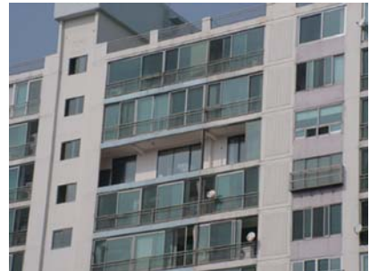
写真3 サッシ・窓ガラスの飛散
