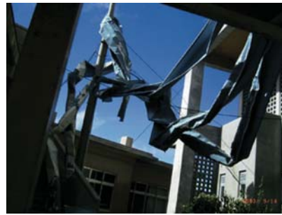
剥がれた屋根材の様子
