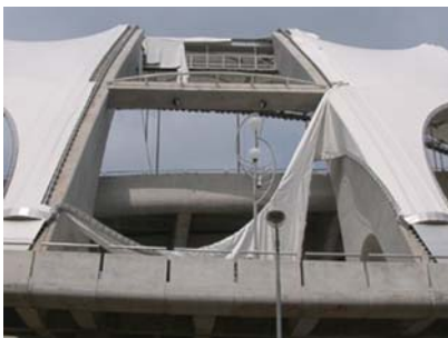
写真4 スタジアムの膜の被害
